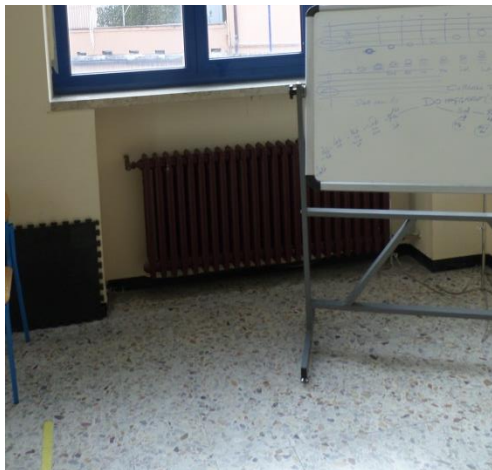
Figura 4.6 - Particolare dei radiatori installati a parete
