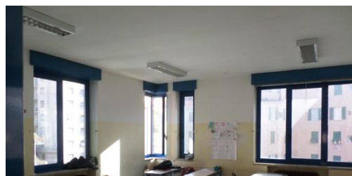
Figura 4.9 - Particolare dei corpi illuminanti ubicati all'ingresso nel corridoio
