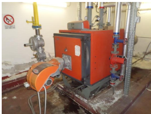
Figura 4.7 - Particolare di caldaia
