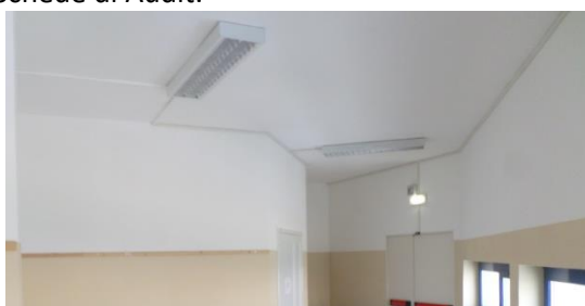
Figura 4.10 - Particolare dei corpi illuminanti corridoio/vano scala
