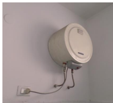
Figura 4.8 - Particolare del boiler elettrico per la produzione di acqua calda sanitaria]
