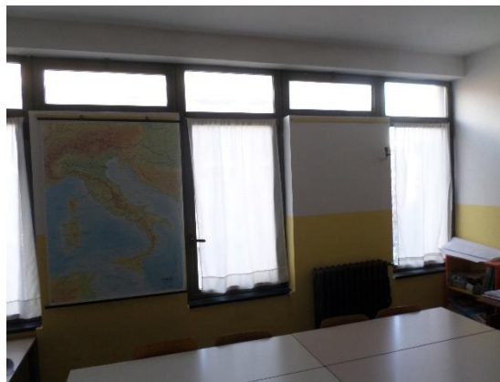
Figura 7.6 – Particolare radiatori attuali
